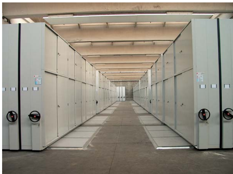
TELECOM ITALIA, ARCHIVIO GENERALE DI TORINO 33.000 metri lineari scaffali mobili
